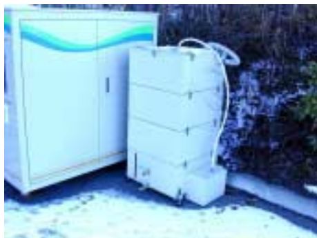
図5 脱臭槽の外観
