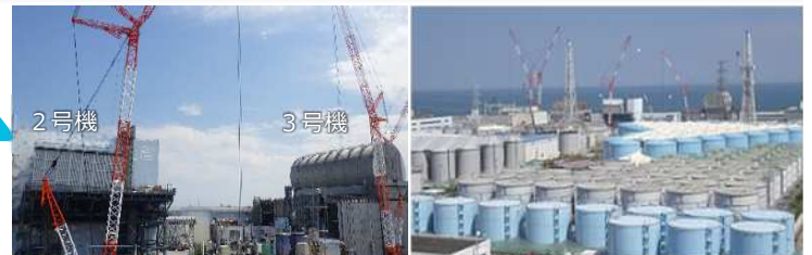
廃炉に向けた作業 ALPS処理水の貯蔵タンク
