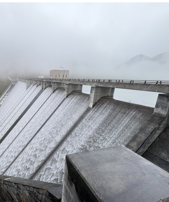
▲新宮川ダム全面越流
