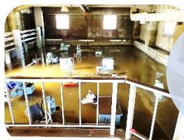
台風による 取水場浸水
