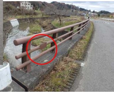
橋名板盗難箇所
