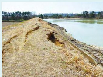
法面のくずれ
