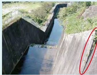
水路側壁の変状
