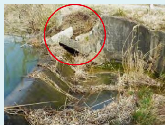
洪水吐の破損
