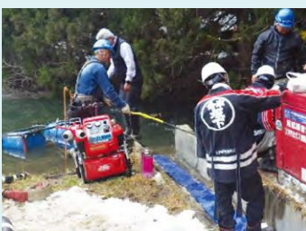
貯留水の緊急排水
