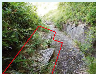
洪水吐の破損
