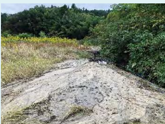
堤体土の流出
