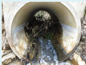
下流水路の閉塞
