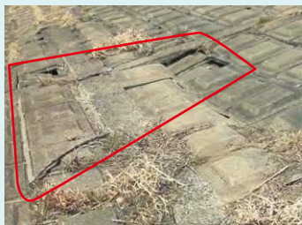
ブロックの破損
