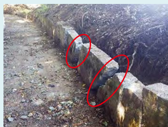
洪水吐の破損
