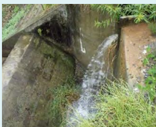
洪水吐の漏水
