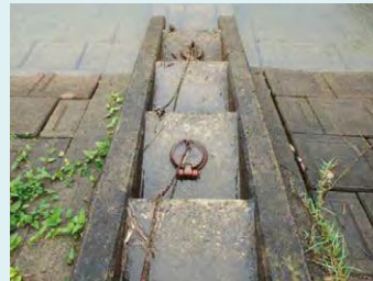
取水栓による水位調整
