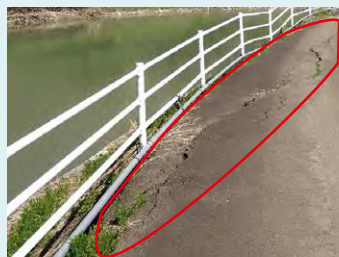
管理道路の亀裂
