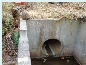
底樋からの漏水
