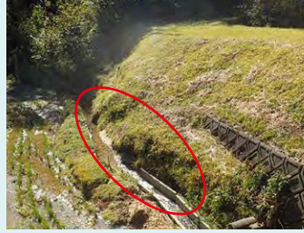
堤体のはらみ出し
