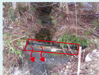
下流水路の堆砂による溢水
