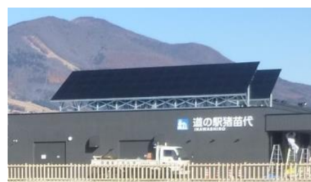
太陽光発電機・自家発電機
