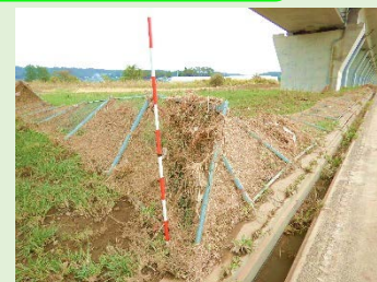
フェンス被災状況
