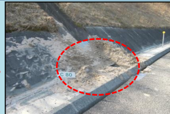
流失土砂 作業前
