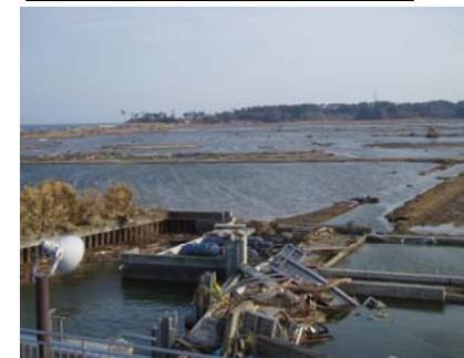
八沢浦排水機場 (南相馬市)
