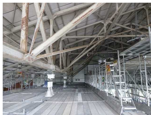
既存天井撤去時の鉄骨躯体状況 → 躯体に錆等の劣化 → 塗装にて仕上げ
