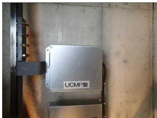
戸開走行保護装置盤
