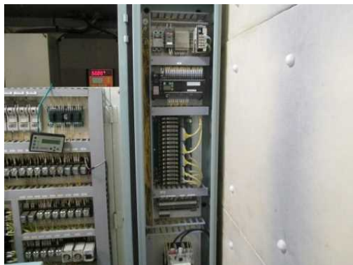
戸開走行保護装置盤
