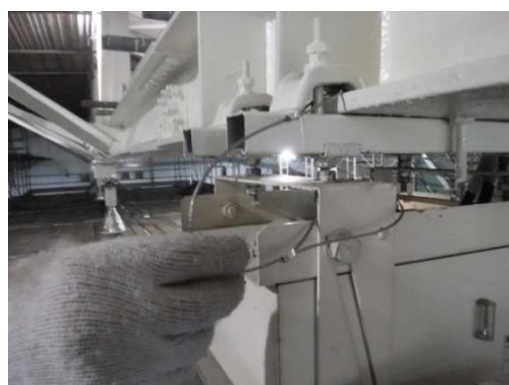
照明設備 ワイヤーによる落下防止措置
