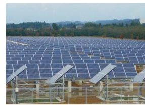
太陽光発電所
