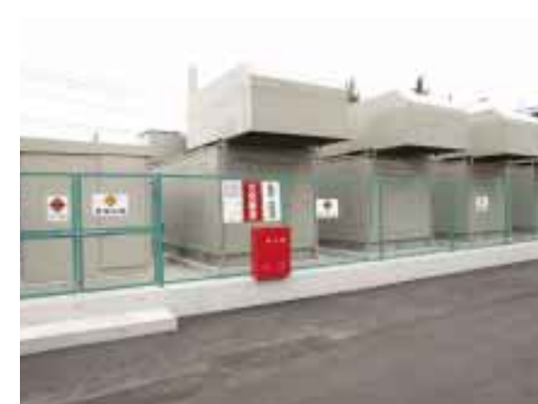
新たに導入した自家発電機
