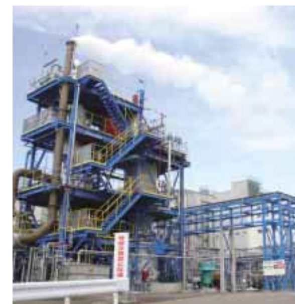
リサイクルシステムの燃焼設備(左手前)と回収設備(右奥) (燃焼設備の煙突から出ているのは水蒸気です)
