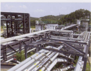
排水処理設備
