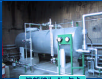
焼却炉サーバータンク
