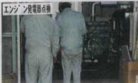
エンジン発電器点検
