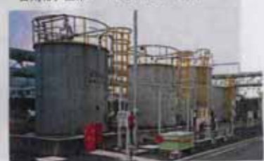
密閉化、窒素シールされたタンク群
