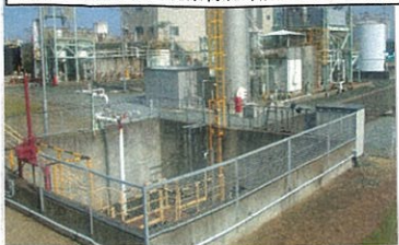
排水水質監視槽、廃棄物焼却炉、廃水処理設備
