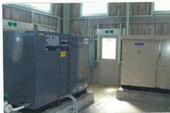
室内に設置した騒音発生施設 (空気圧縮機, 発電機)
