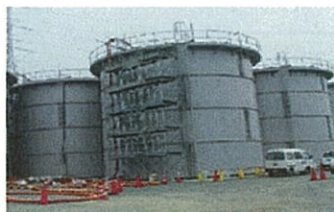
フランジ型タンク
