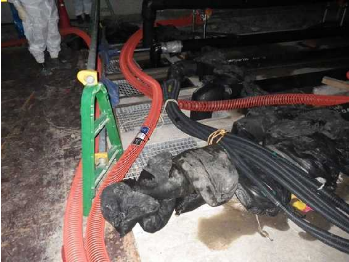
3 土嚢で側溝への流入を防止している箇所
