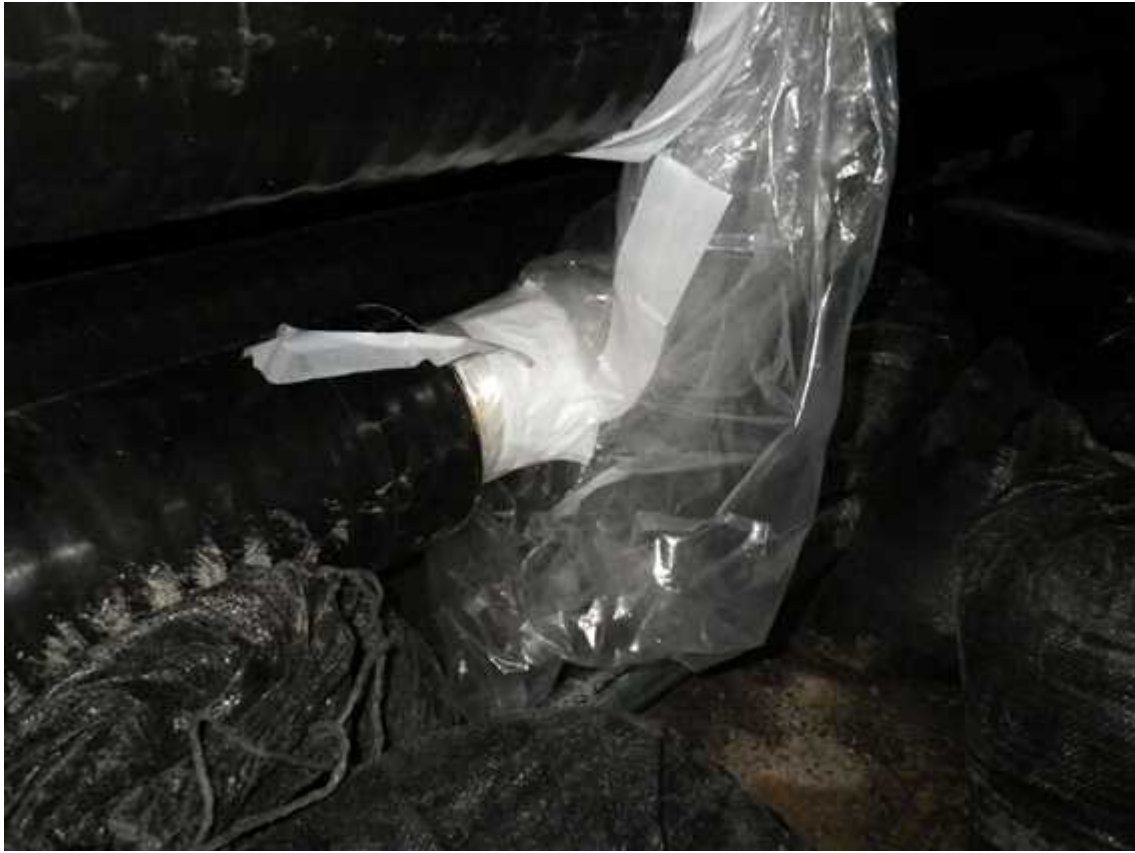
2 処理水漏えい部
