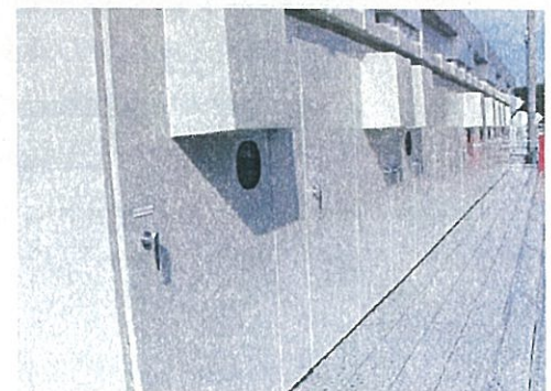
新事務棟高圧受変電設備（全体写真）
