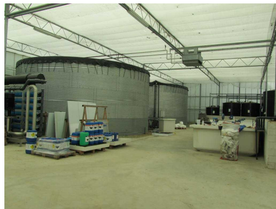
養液混合施設（精製・消毒した雨水と養液を混合）
