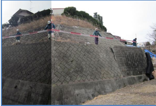
工事着手前(擁壁被災状況)
