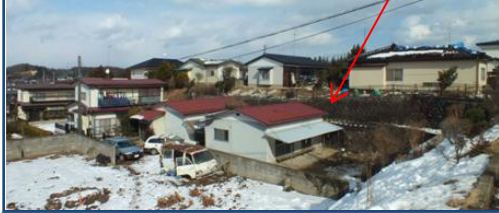
工事着手前(擁壁被災状況)
