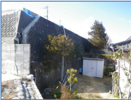
工事着手前(擁壁被災状況)
