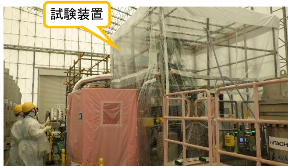
(写真 1－1) 減圧乾燥設備の概観
