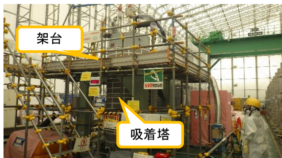
(写真 1－2) ハウスの傍に設置された吸着塔
