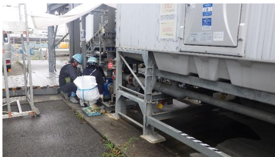
（写真1①）冷却塔ポンプ点検①
