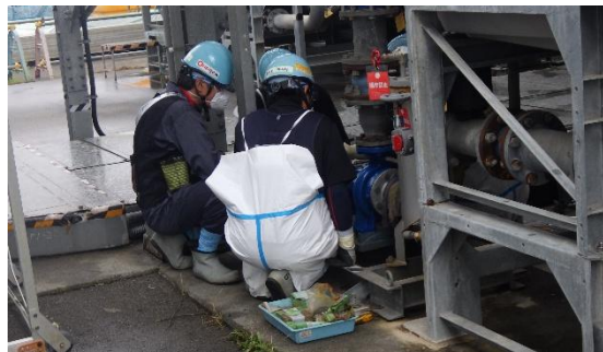
（写真1②）冷却塔ポンプ点検②
