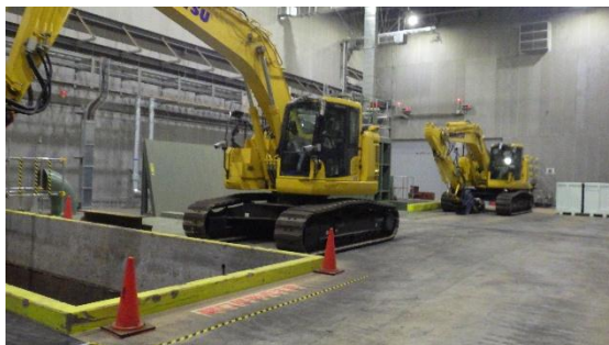
(写真 5 ①) 減容処理設備の金属減容処理室の様子
