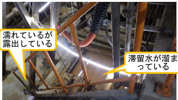
(写真3) 5号機タービン建屋の滞留水の状況
