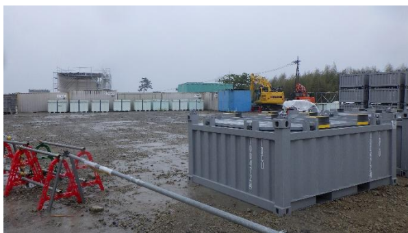
(写真 8－3) 瓦礫類一時保管エリア E 1 の状況③ (前回確認時)
