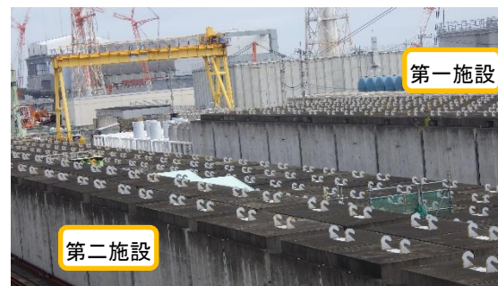
(写真 3 ③) ボックスカルバートに よる保管状況の鳥瞰②
