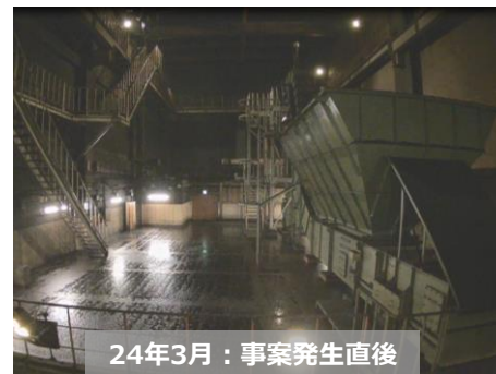
廃棄物供給室
