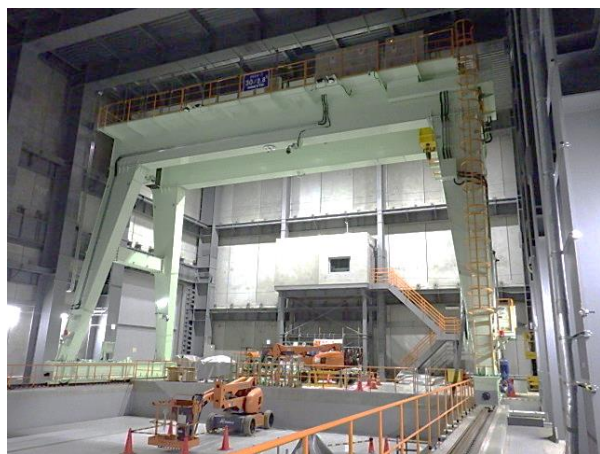
吸着塔取扱クレーンの外観
