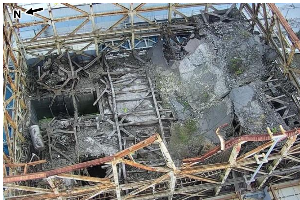
ガレキの状況（大型カバー設置前）
