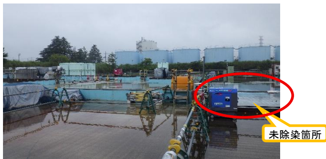
(写真 7-3) 未除染の箇所の状況 青色の印は、残存したまま ※令和 8 年 8 月 3 日撮影
