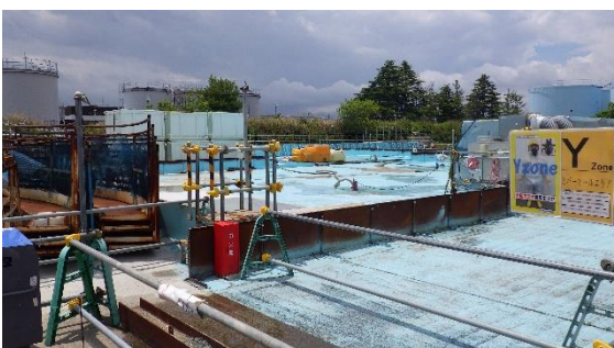
(写真6-5) 前回確認時の状況① ※令和8年6月19日撮影
