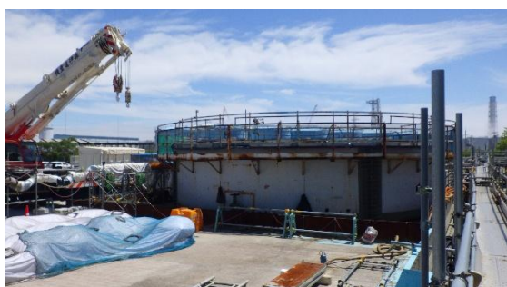
(写真6-3) 前々回確認時の全景② ※令和8年5月28日撮影
