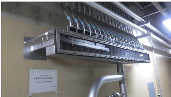
(写真 2) 漏えい目視箱の状況
