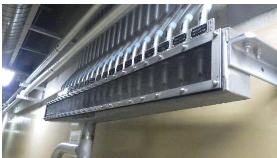
(写真2－2) 漏えい目視箱(地下階) の状況
