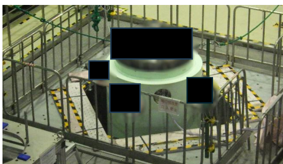
(写真1) キャスク除染ピットにおける キャスク設置状況
