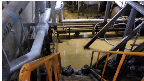
(写真 1－4) 5号機タービン建屋地下階における 滞留水の状況④ (今回確認時)
