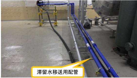
(写真 3－2) 滞留水移送用の配管の状況②
