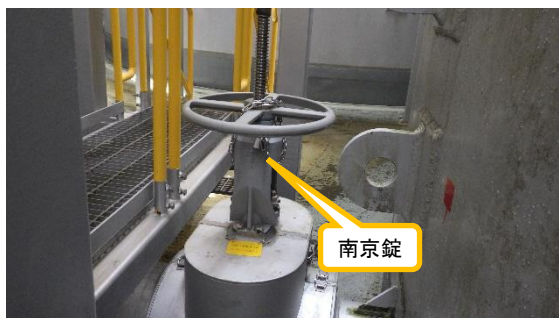
（写真２）弁操作後の施錠状況
