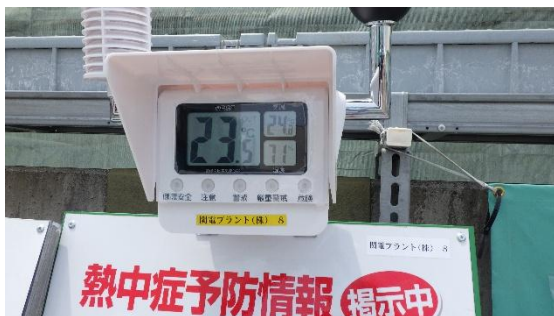
(写真 7－1) 熱中症予防情報表示器の設置状況
