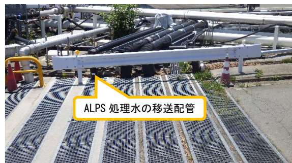
(写真 6－2) A L P S 処理水の移送ルート確認状況④ (道路を横断し、グレーチングを立ち上げる部分)
