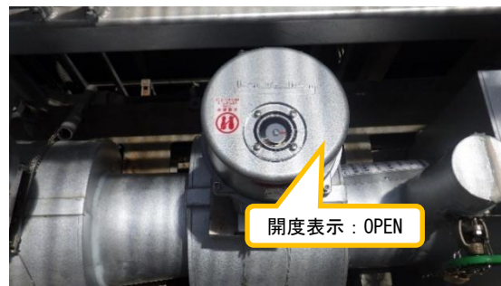
(写真 5－2) A L P S 処理水の移送ルート確認状況② (交換済の払い出し弁は開放状態であった。)
