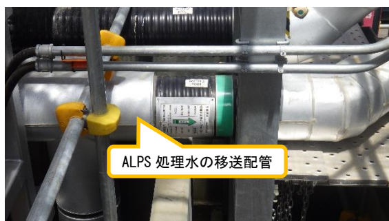
(写真 6－1) A L P S 処理水の移送ルート確認状況③ (エルボウ部)
