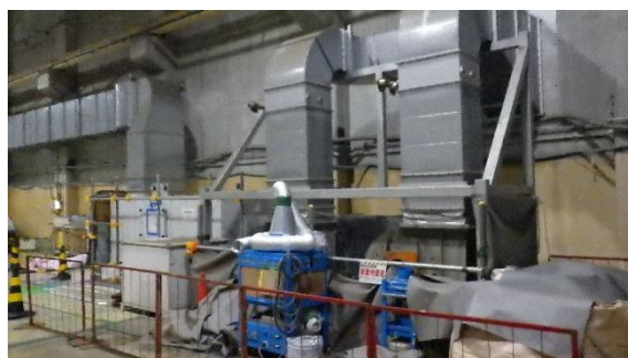
(写真2-1) ダクト部分に設置されたダストモニタ
