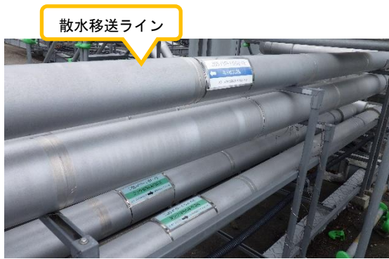
(写真3) J 2 及び J 3 雨水回収タンク からの散水移送ラインの状況
