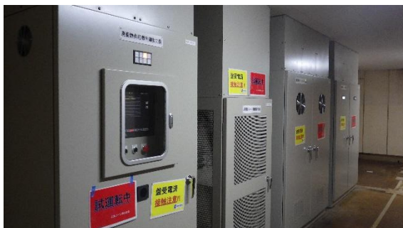
(写真 1 - 5) 新設された制御盤等①
