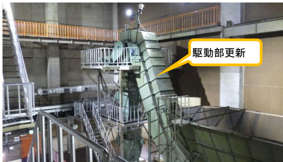
(写真 1 - 1) 廃棄物供給機及び廃棄物投入機① (コンベアモーター部を更新)
