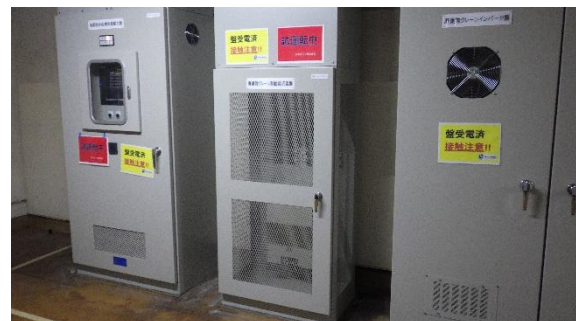
(写真 1 - 6) 新設された制御盤等②
