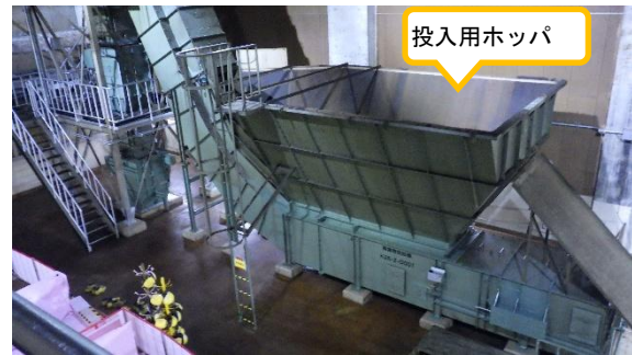
(写真 1 - 2) 廃棄物供給機及び廃棄物投入機② (廃棄物輸送用コンベアを更新)
