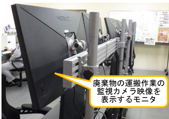
(写真 1) 減容処理設備における監視カメラモニタの設置状況
