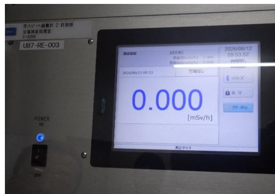
(写真 2) 減容処理設備における空間線量率の遠隔監視状況
