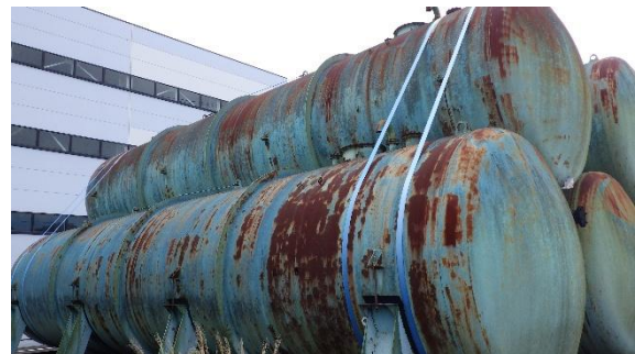
(写真5) 表面の腐食
