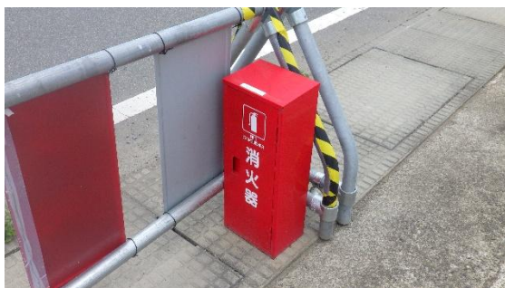
(写真 5) 消火器の設置状況
