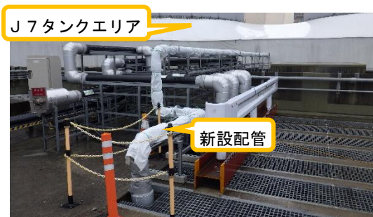
(写真 1 ①) J 7 タンクエリアに設置された配管 ※白い布で覆われている配管が新設された配管
