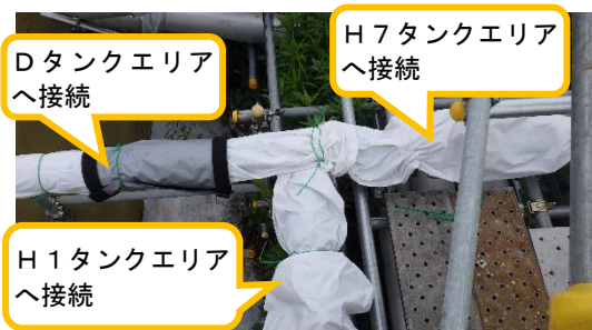
(写真 1 ③) 配管の分岐地点
