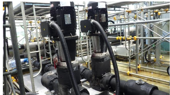
(写真5①) 移送ポンプ①
