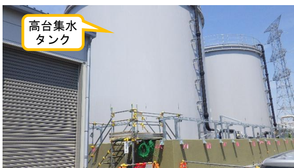
(写真1①) 高台集水タンク
