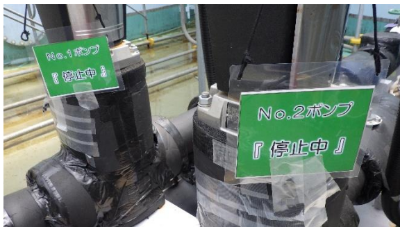
(写真5②) 移送ポンプ②
