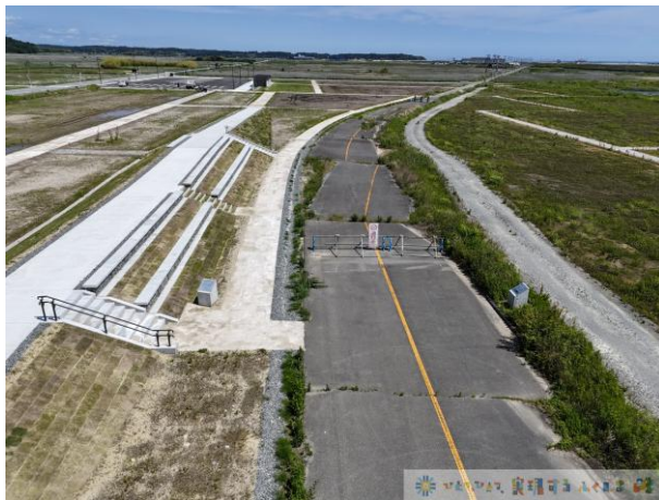
写真11 水辺の広場(舗装の損傷箇所)を北方向に望む
