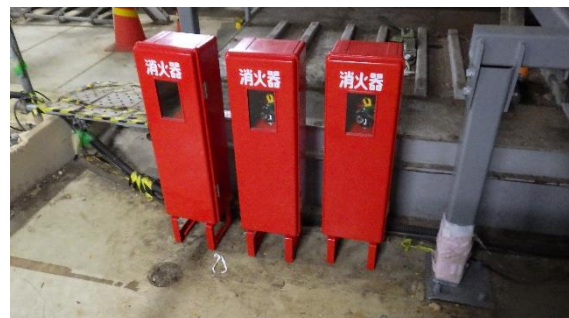
(写真 2) 2号機タービン建屋における 消火器の設置状況
