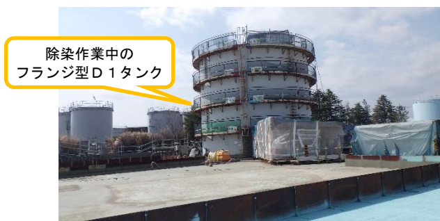
（写真1-1）フランジ型D1タンクの全景 ※令和8年3月25日撮影
