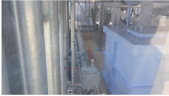
(写真3-1) ALPS処理水希釈・放出設備
