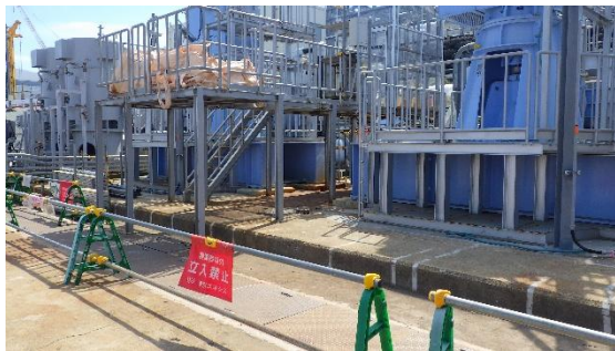
(写真3-3) 海水汲み上げポンプ
