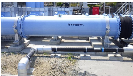
(写真3-4) 海水移送配管
